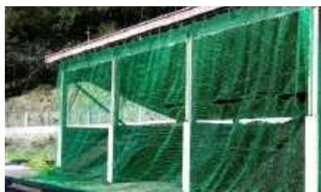
◆畜舎、堆肥舎等への防鳥ネットの設置
